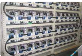
システム内部 蓄電池
