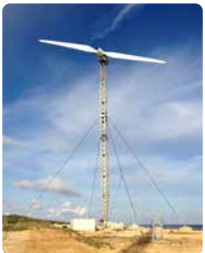
風力発電機 (沖縄電力殿)
