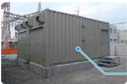
石津川変電所
