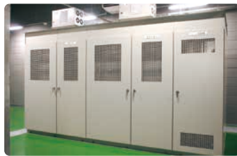
東京モノレール 品川変電所
