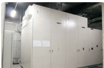
横浜市交通局 ブルーライン 高島町変電所
