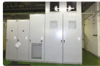
札幌市交通局 中の島変電所、鉄北変電所
