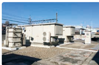
JR東日本 東北本線 久喜変電所
