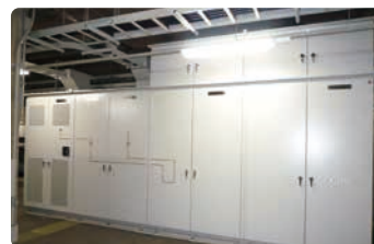
Osaka Metro 四つ橋線 北加賀屋変電所
