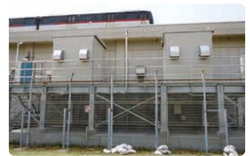
東京モノレール 多摩川変電所
