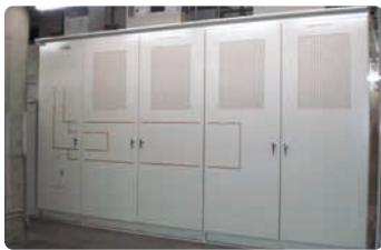
Osaka Metro 千日前線北巽変電所
